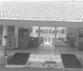
Gambar 24 Ramp Area Taman dengan Rubber Ramp Namun Tanpa Handrail dan Curam
