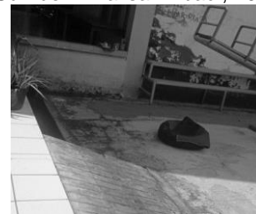
Gambar 22 Ramp Area Bermain Tanpa Rubber Ramp , Handrail , dan Curam Sumber: Analisa Pribadi, 2024
