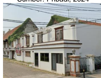
Gambar 4. Kerusakan pada bagian Selatan Bangunan Sumber: Google Street View https://shorturl.at/meYBI , 2023
