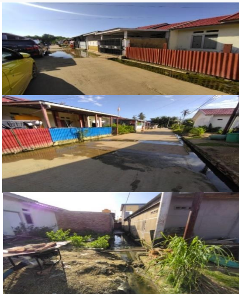
Gambar 3. Sanitasi Perumahan yang Tersumbat
