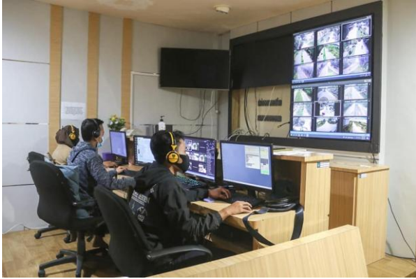
Gambar 8. Ruang CCTV Engku Putri Square
