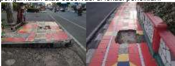
Gambar 2. Elevasi trotoar dan kondisi lubang pada trotoar.
