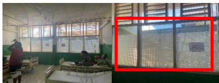
Gambar 5. Kondisi Eksisting ruang kelas III kekurangan cahaya alami
