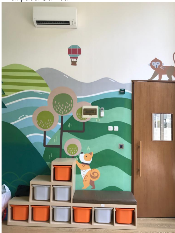
Gambar 7. Perletakan AC Sumber: Dokumentasi Pribadi
