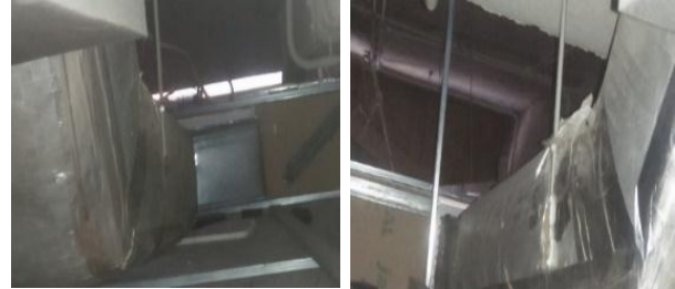
Gambar 11. Salah Satu Unit Ducting (Sumber : Penulis,2021)
