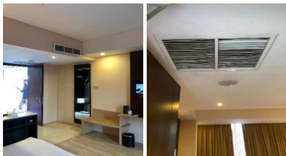
Gambar 9. Unit AC Indoor FCU (Kiri) dan Diffuser Return (Kanan)
